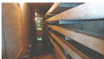
Chemins de câbles
