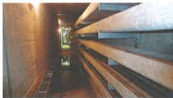
Chemins de câbles
